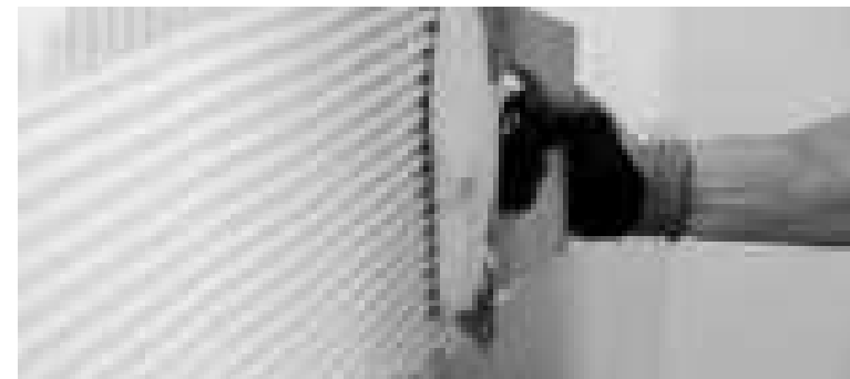
Make sure the thickness of the layer of adhesive cement is uniform | Asegúrate de que el grosor de la capa de cola sea uniforme | Veiller à ce que l'épaisseur de la couche de ciment colle soit uniforme | Vergewissern Sie sich, dass die Kleberschicht gleichmäßig ist
